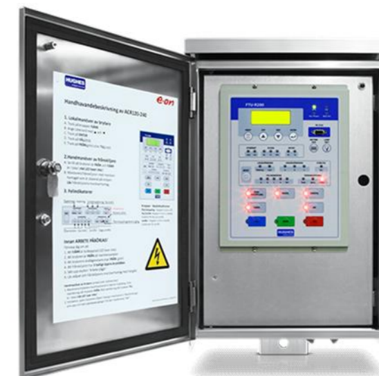
Рис. 1.3 – Шафа захисту і телемеханіки
